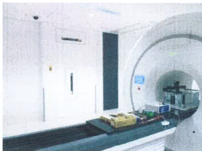
平成28年 伯鳳会大阪暁明館病院 陽子線クリニック X線治療室
